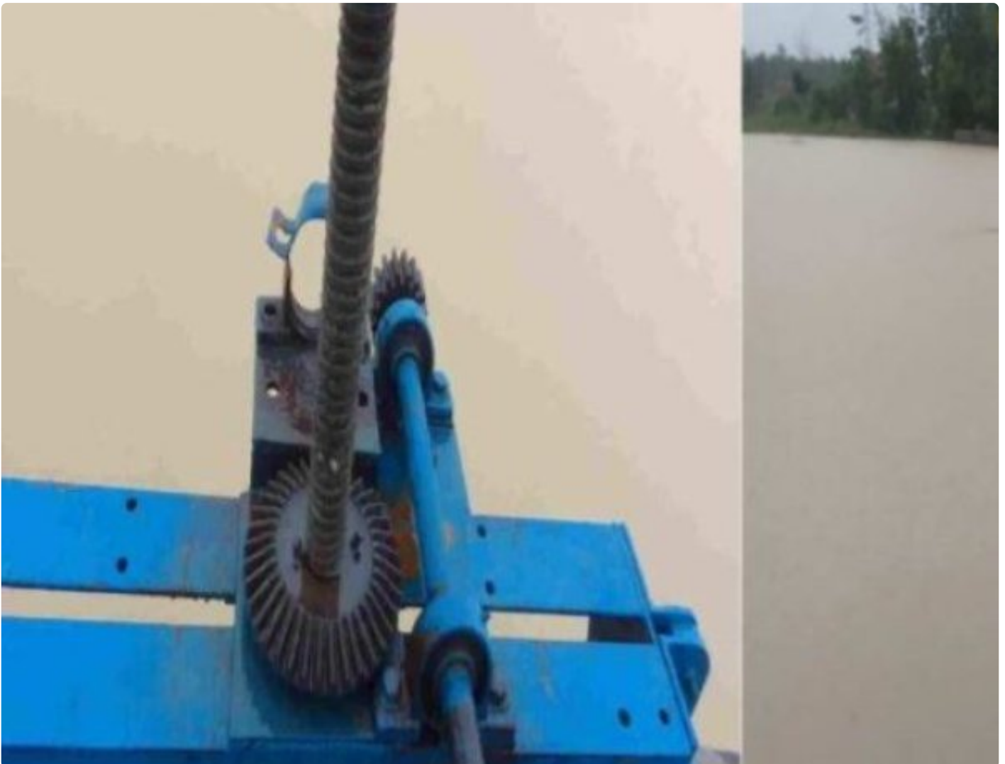
Pintu air Albaret Simpang Mesuji
